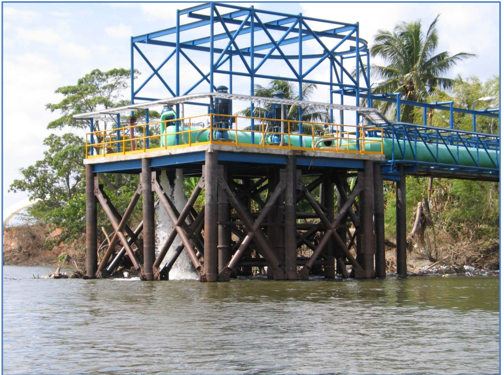
Captación “Carrizal 1” en el río Carrizal
