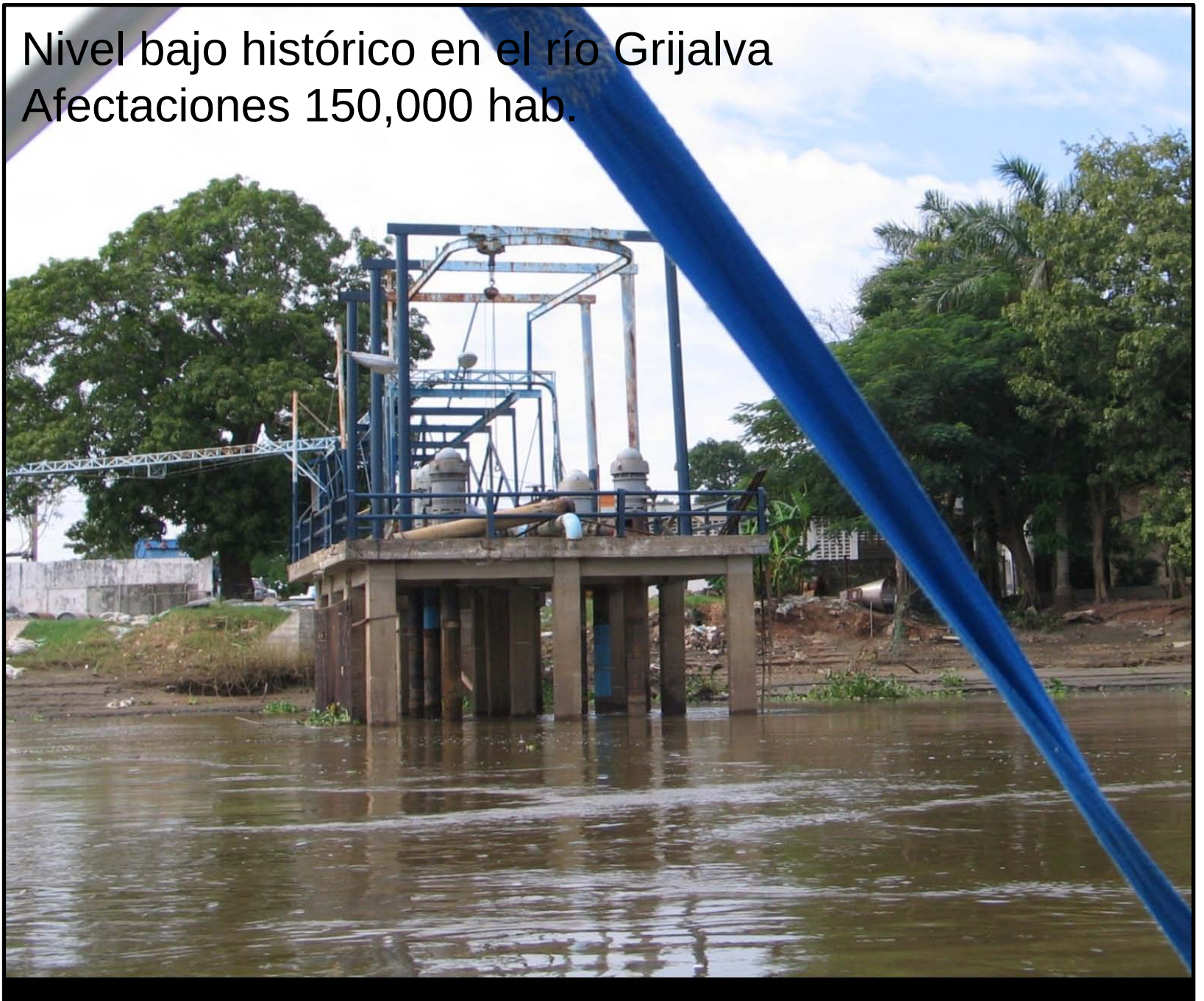
Captación "CICOM" en el río Grijalva
